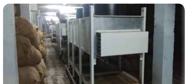
Bhagyodaya Cold Storage, Raichur (KA)
